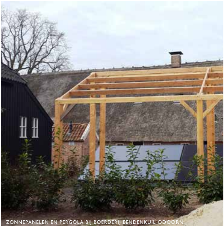
ZONNEPANELEN EN PERGOLA BIJ BOERDERIJ EENDENKUIL ODOORN
